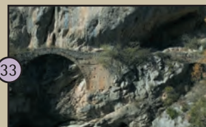
33 Los Pontarrons: Obra viaria construida en la primera mitad del siglo XI, bajo el patrocinio del obispo Ermengol de Urgel, para circular por la garganta de Trespunts.
